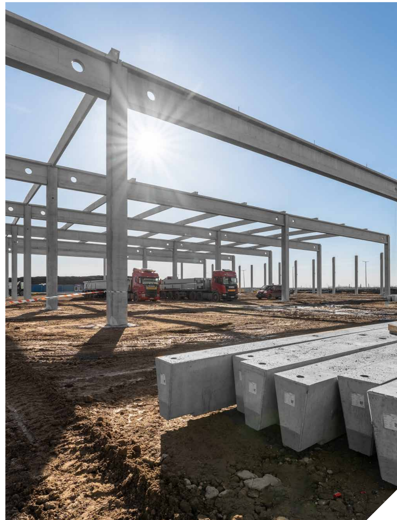
ZF Panattoni, Kecskemét Átadás éve: 2024. Szállított termékek: komplett előregyártott szerkezet Alapterület: 17.703 m 2 Legyártott mennyiség: 1.670 m 3
