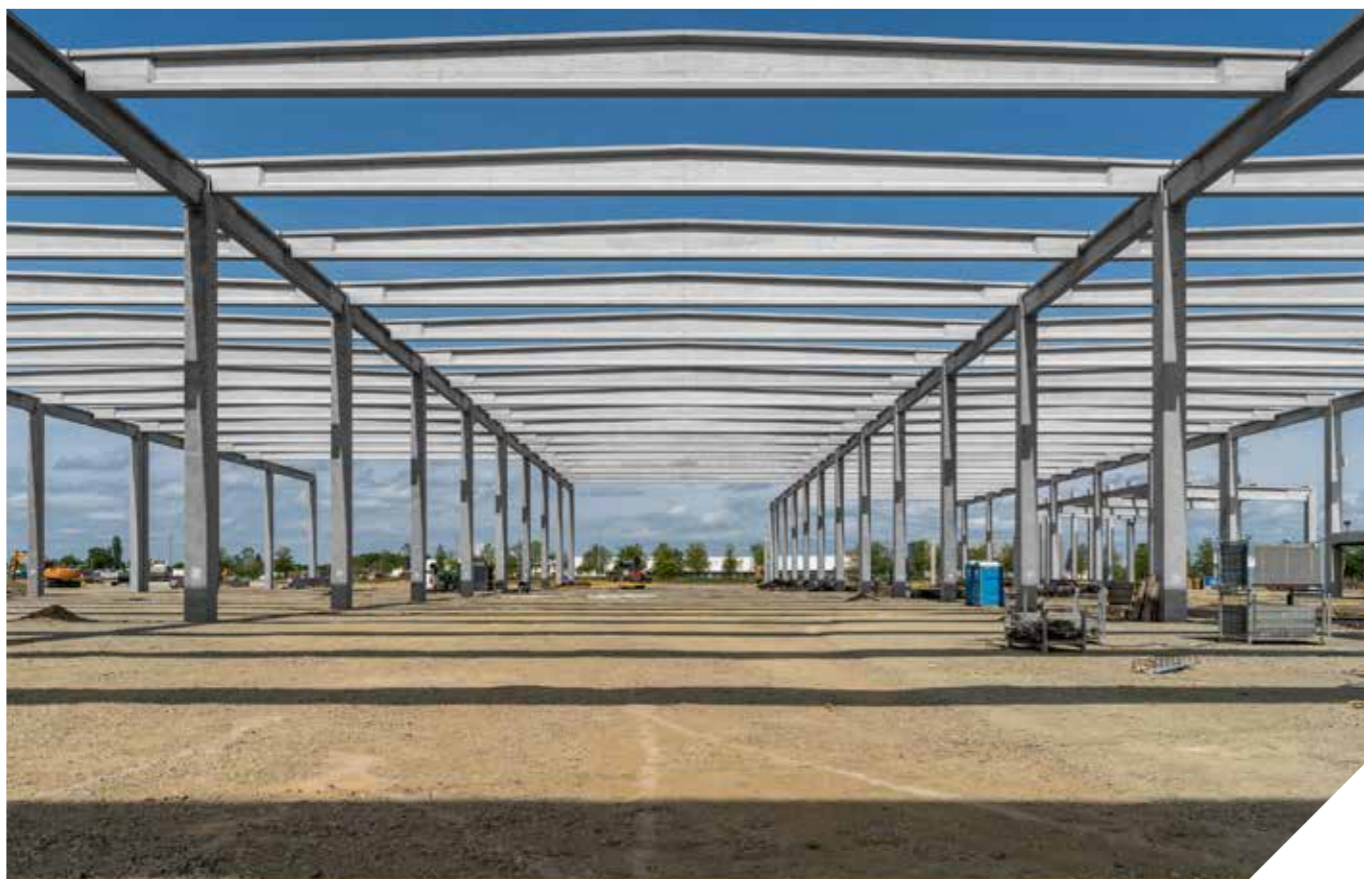
Benepack, Makó Átadás éve: 2024. Szállított termékek: komplett előregyártott szerkezet Legyártott mennyiség: 3.642 m 3
